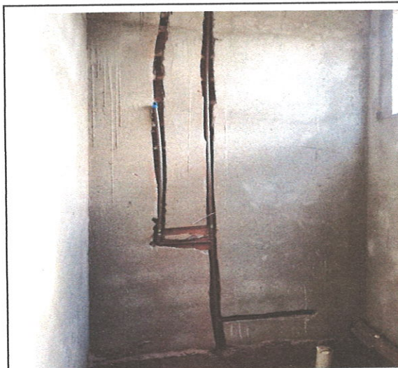
FOTO 26: Rede de água fria
